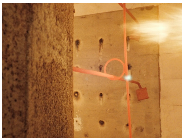
Bild A3-11 Wasseraustritt aus den Durchführungen – 22. Minute
