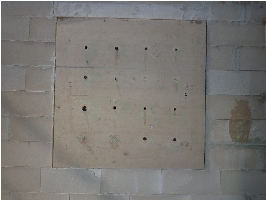
Bild A3-18 Ansicht des Probekörpers von der brandzugewandten Seite nach der Brandprüfung
